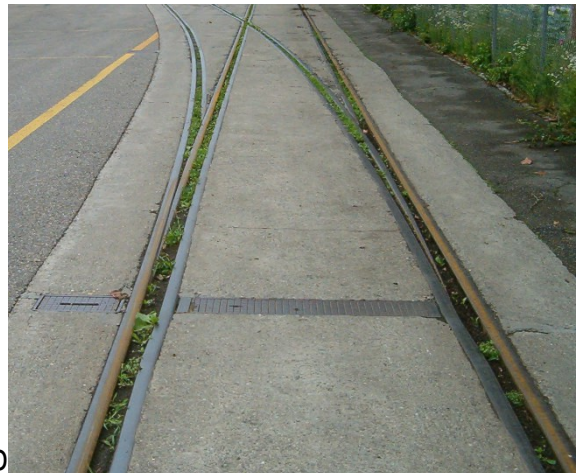
Aiguillage 171 en position initiale à dro
